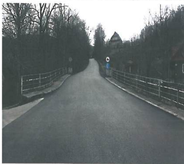
Fot. 10.2.2 Odcinek drogi powiatowej nr 2072K po wykonaniu remontu w miejscowości Kamionna
