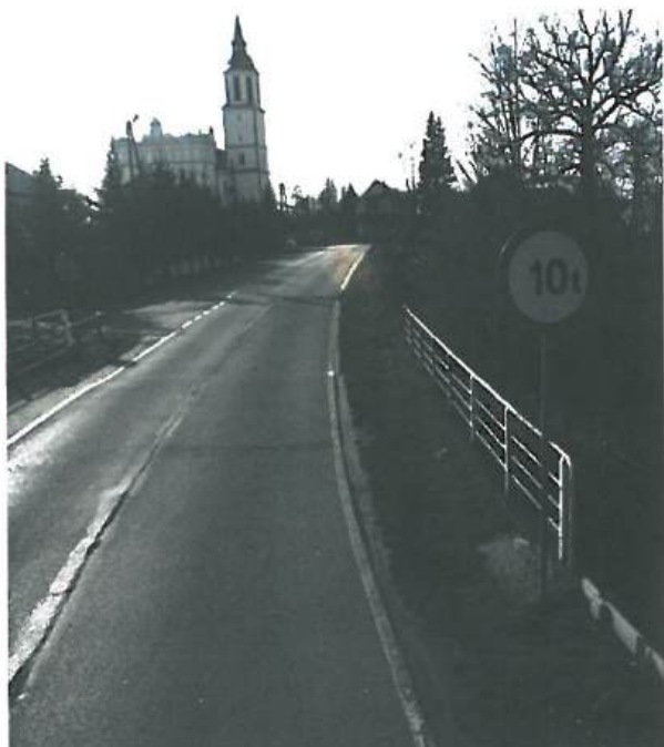
Fot. 5.6.1. Odcinek drogi powiatowej nr 2094K w trakcie rozbudowy drogi w miejscowości Okulice
