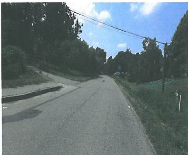
Fot. nr 5.1.1 Odcinek drogi powiatowej nr 2095K przed rozbudową drogi w miejscowości Trzciana
