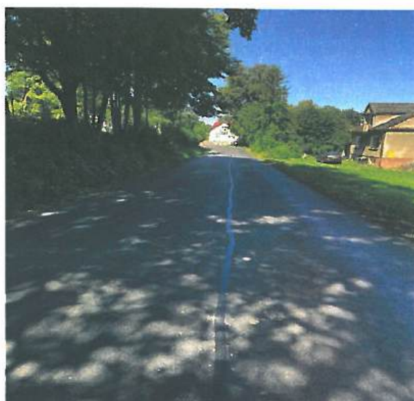
Fot. 5.12.2 Odcinek drogi powiatowej nr 2071K po przebudowie drogi w miejscowości Ujazd
