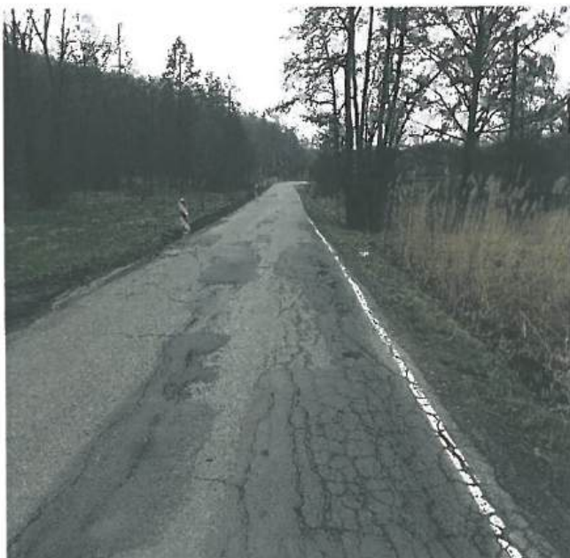
Fot. nr 5.4.1 Odcinek drogi powiatowej nr 1444K przed rozbudową drogi w miejscowości Olchawa
