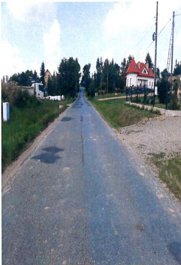
Fot. 5.10.1 Odcinek DP nr 2080K przed przebudową drogi w miejscowości Wiśnicz Mały
