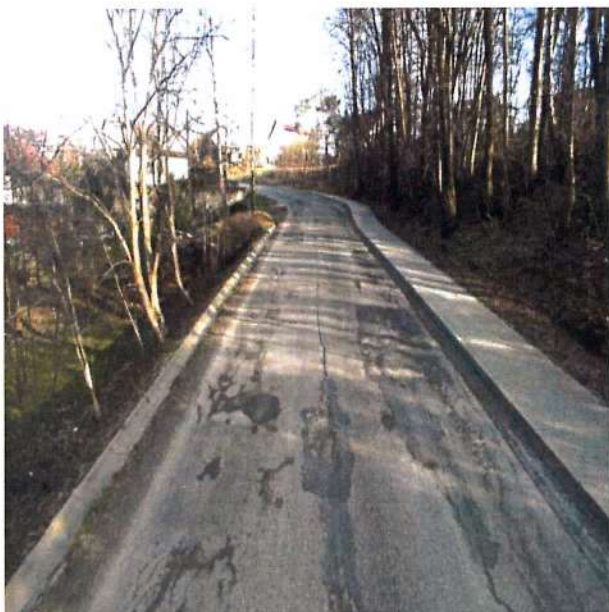
Fot. 5.11.1 Odcinek DP nr 1444K przed przebudową drogi w miejscowości Nowy Wiśnicz
