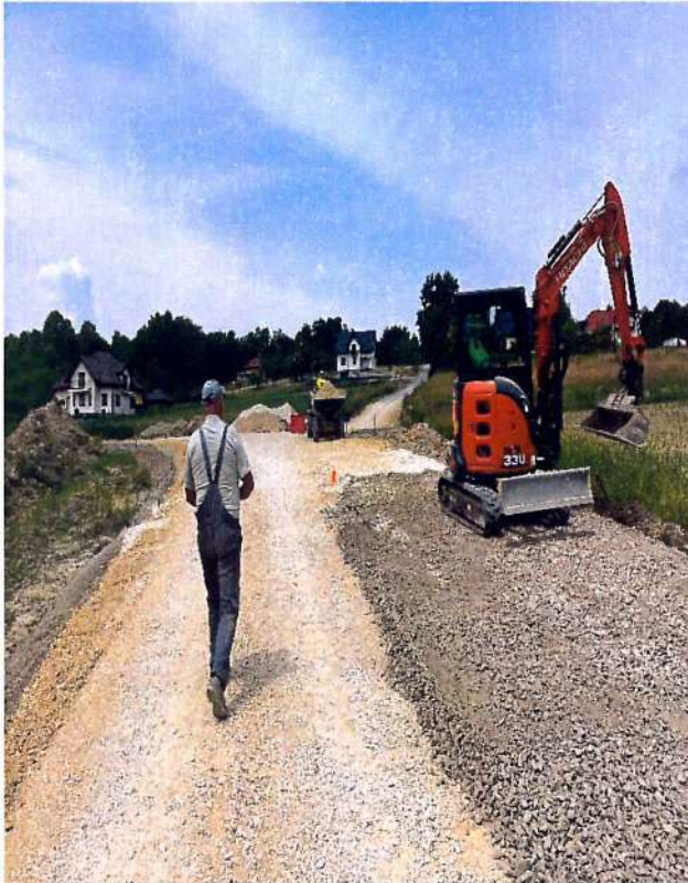
Fot. 5.1.5 Odcinek drogi powiatowej nr 2074K w trakcie realizacji robót w miejscowości Beldno
