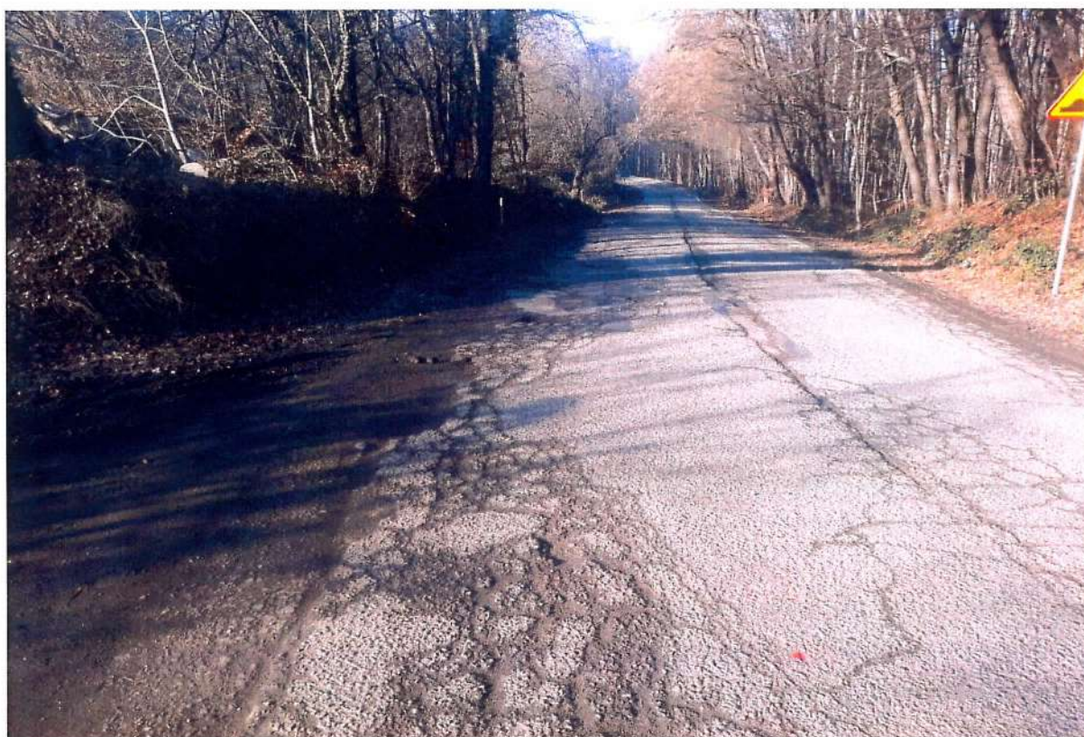
Fot. 5.1.3 Odcinek drogi powiatowej nr 2077K przed rozbudową drogi w miejscowości Lipnica Górna
